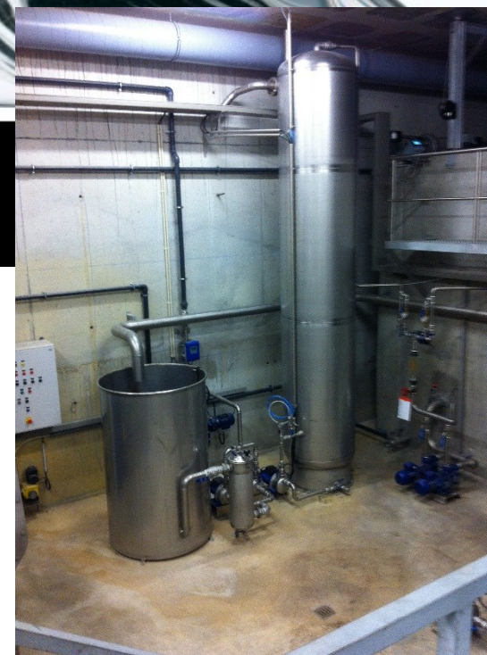
Sistema de desinfecção por ozono
