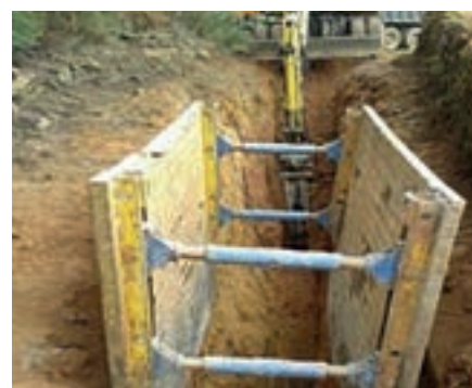
Figura 15 EB 2273: Rede de drenagem de águas residuais de Lamelas (Santo Tirso). Sistema de Águas da Região do Noroeste (dez/2014)
