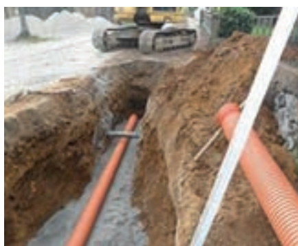
Figura 14 EB 2272 - Rede de drenagem de águas residuais de Guimarei (Santo Tirso). Sistema de Águas da Região do Noroeste (nov/2014)
